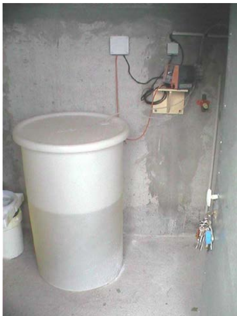
Poste de Chloration
