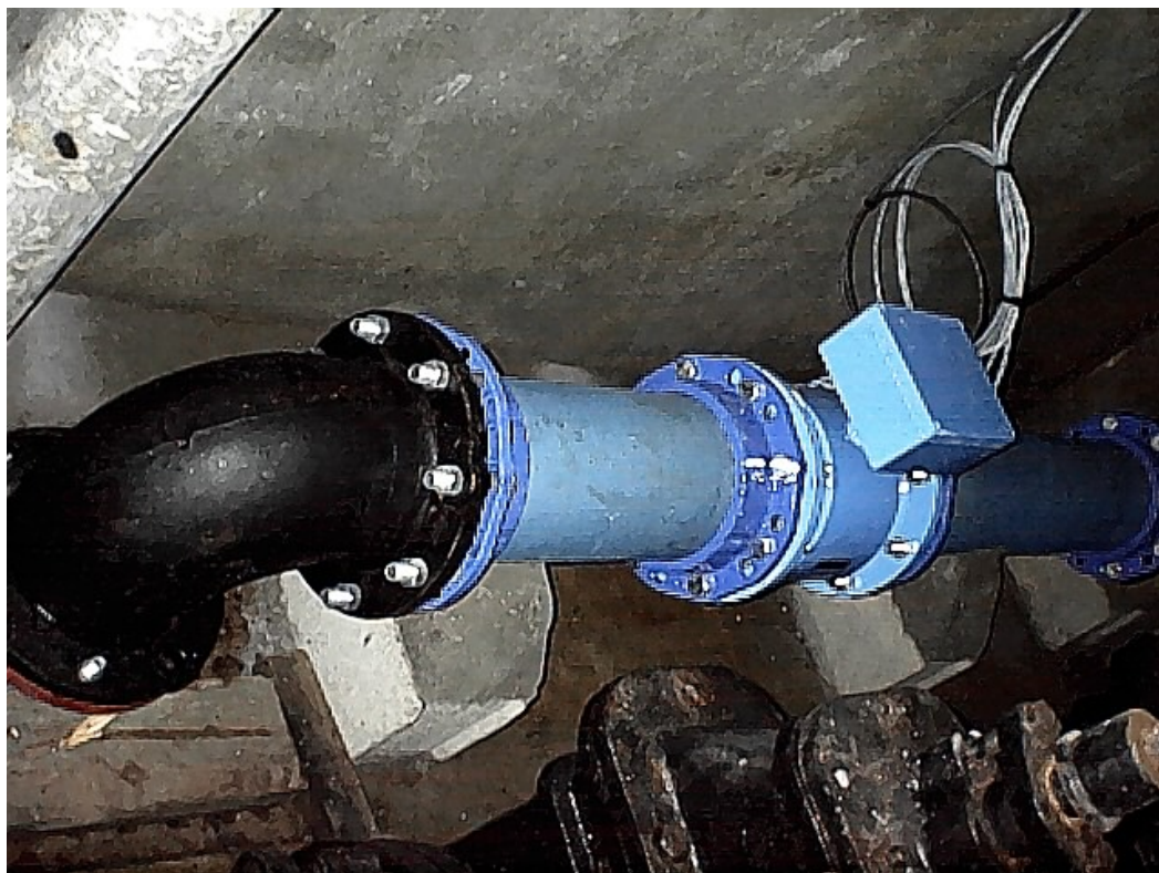
Débitmètre de la surverse.
